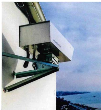
Рисунок 1 – Оборудование FSO, смонтированное на уровне крыши дома
