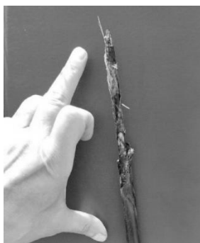
Рисунок 2 – Механическое повреждение ВОК
